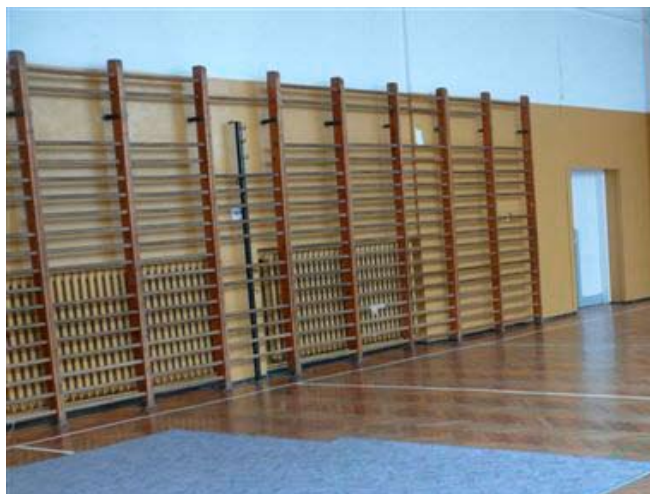
Sala gimnastyczna przed remontem (widoczne miejsca doraźnych remontów)
